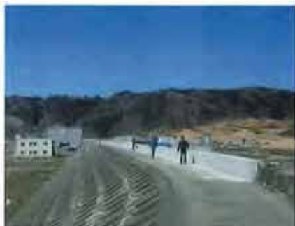
沈下で1m嵩上げされた堤防
