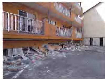
熊本地震により1階ピロティの破壊による被害
