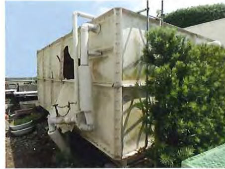
写真8 上部パネル破損、接続配管の折損
