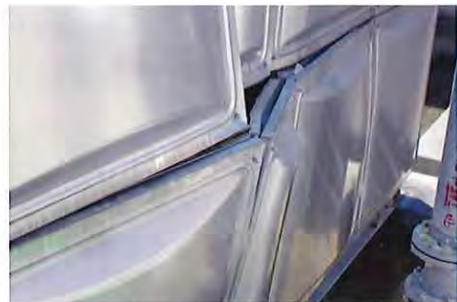
写真6 SUSパネル水槽下部継ぎ目の破損
