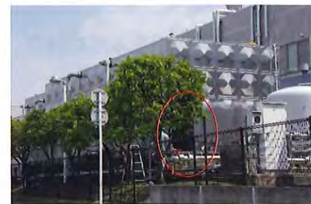
写真10 隅部下部の側板の破損
