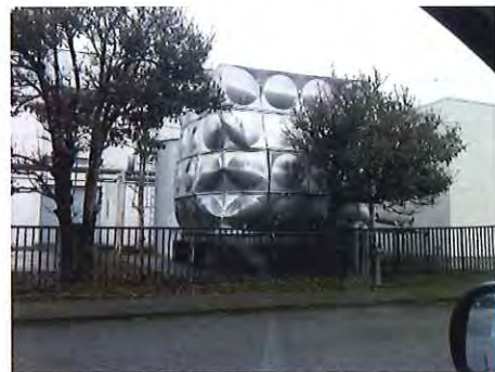
写真7 SUSパネル隅部の底部の破損
