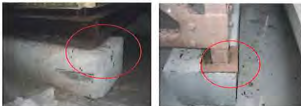
写真 13 コンクリート基礎へ固定されていない
