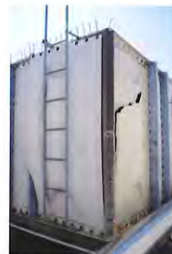
写真3 天板や側板の破損
