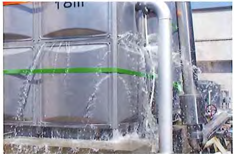
写真5 SUSパネル下部の継ぎ目の破損
