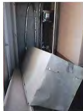
写真11 メーターボックス内設置の温水器が転倒
