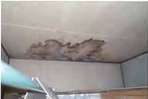
最上階住戸内の漏水の状況
