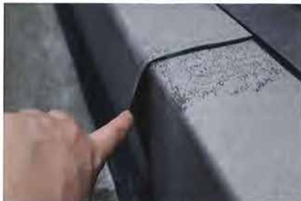
屋上防水シート重ね部分の剥離状況
