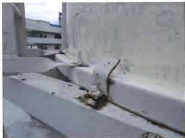
既存高置槽本体の固定方法は旧式の挟み込み式
