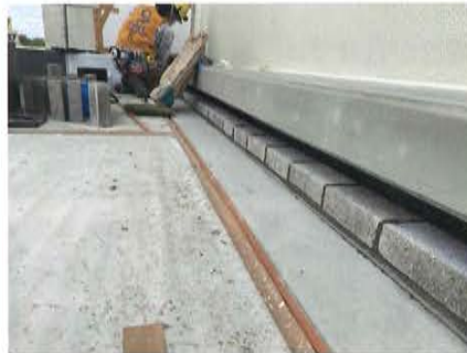
写真30 既存防水層に増し貼りし、立ち上がり端部で押え、保護コンを打設、顎下にブロックを積み隠蔽
