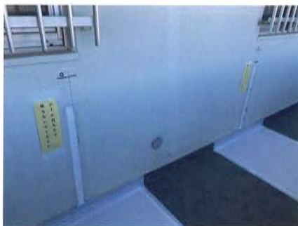
写真24 壁にスリットを施工、耐火バッカー材を入れ、耐火シールを施工
