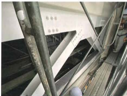
写真22 ブレース全面に耐久性を考慮して厚膜ポリウレタン樹脂塗装、上面はモルタルを詰めて塗膜防水を施工
