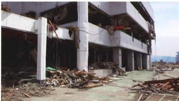
写真 13 第 1 次調査の高野会館 (2011 年 5 月 3 日)
