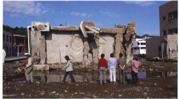
写真4 第5次調査の旧女川交番 (2011年11月3日) 沈下した地盤面に横たわっている。
