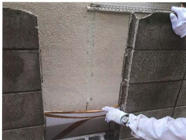
写真5 マンション隣接のCBを一部除却しスリットを新設した
