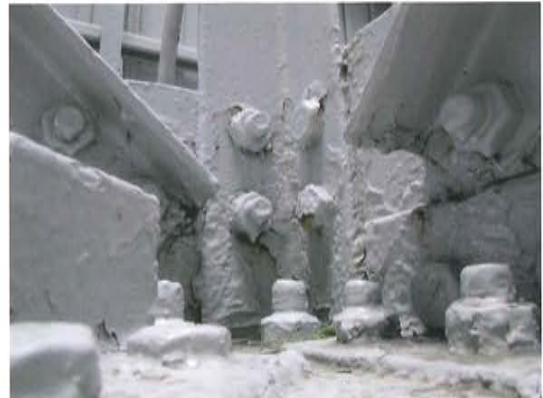
写真3 屋上大型看板の接手ボルトの劣化状況
