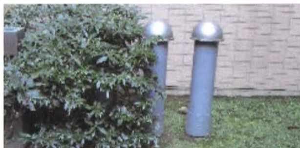
写真2 通気口は地面より高くして浸水を防止
