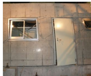
写真2 外壁とドア ドアやサッシは変形
