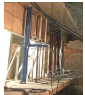
写真3 立て配管 取出配管が変形
