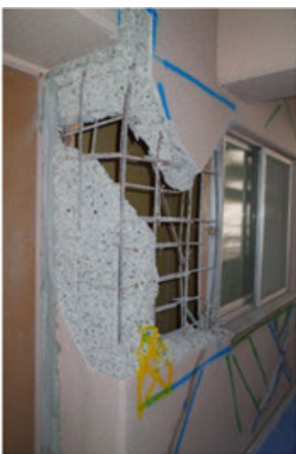
共用廊下の非構造壁に生じた貫通ひび割れの補修状況 室内側に居住空間と施工空間を分離する区画を設けている
